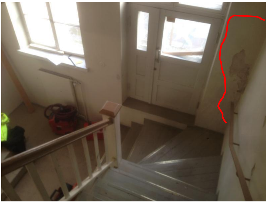
Kuva 49: 2. ja 3. kerroksen välinen portaikko. Ulkoseinässä kosteutta
