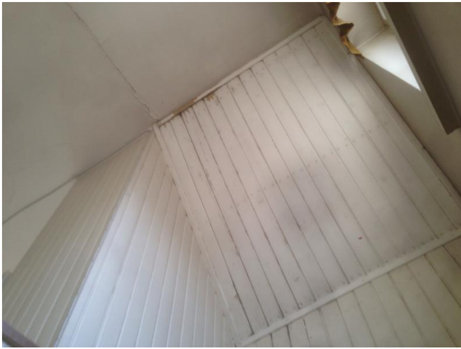
Kuva 50: Portaikon yläosassa kosteusjälkiä
