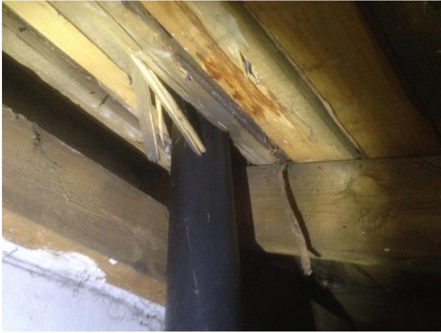
Kuva 60: Läpiviennin ympärillä kosteusvauriota aluslaudoituksessa
