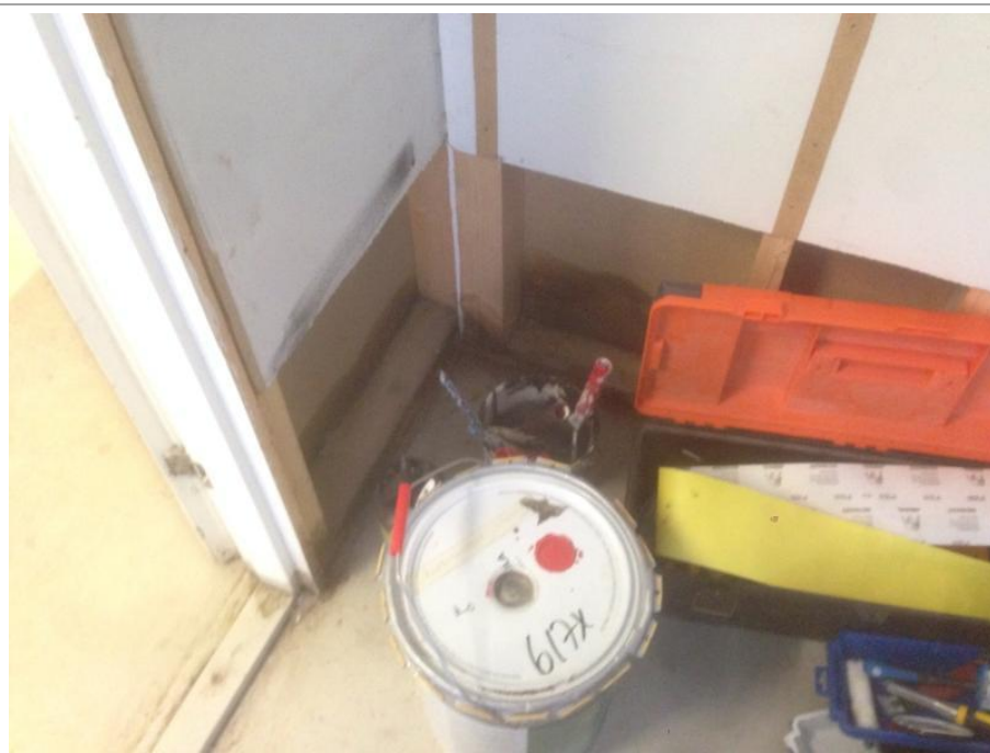
Kuva 33: Lastulevyseinien alaosissa kosteusvaurioita
