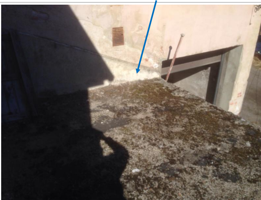
Kuva 74: Seinän ja betonikaton liitosvuoto
