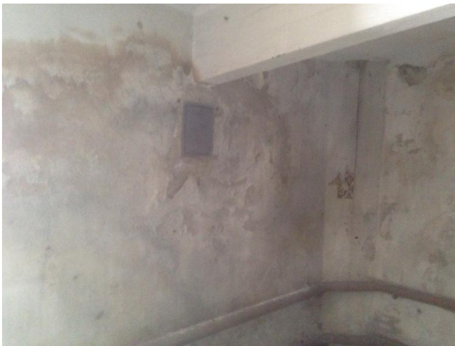
Kuva 96: Kosteusvaurio korjatun autotallin yläpohjassa ulkoseinässä
