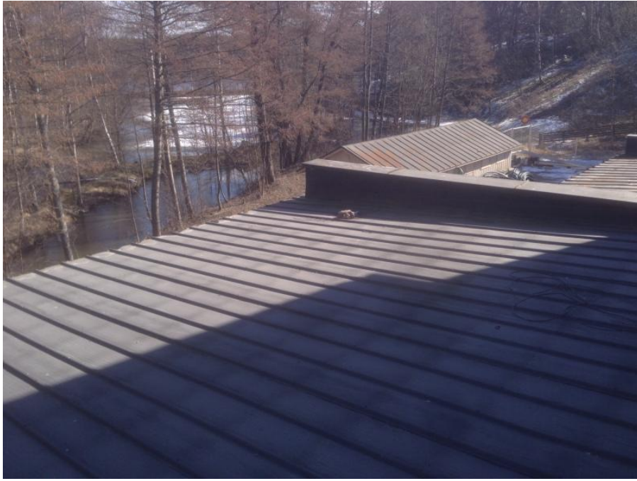
Kuva 83: Vesikaton kulmassa vuoto
