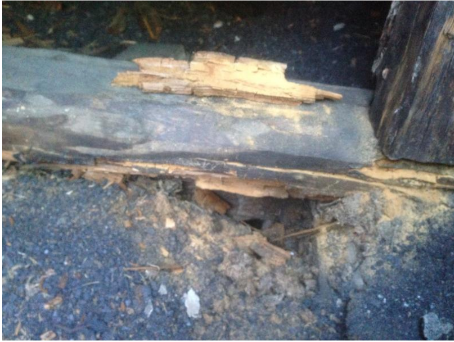
Kuva 77: Lahovikaa yläpohjan rakenteissa
