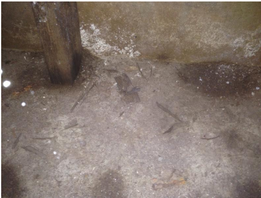
Kuva 23: Vanhassa johtokuiluissa on puurakenteet kosteusvaurioituneet
