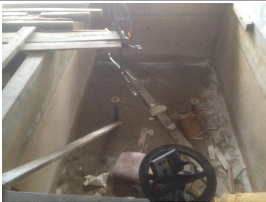
Kuva 26: Vanha vesisäiliössä jossa on jätettä ja hiekkaa pohjalla
