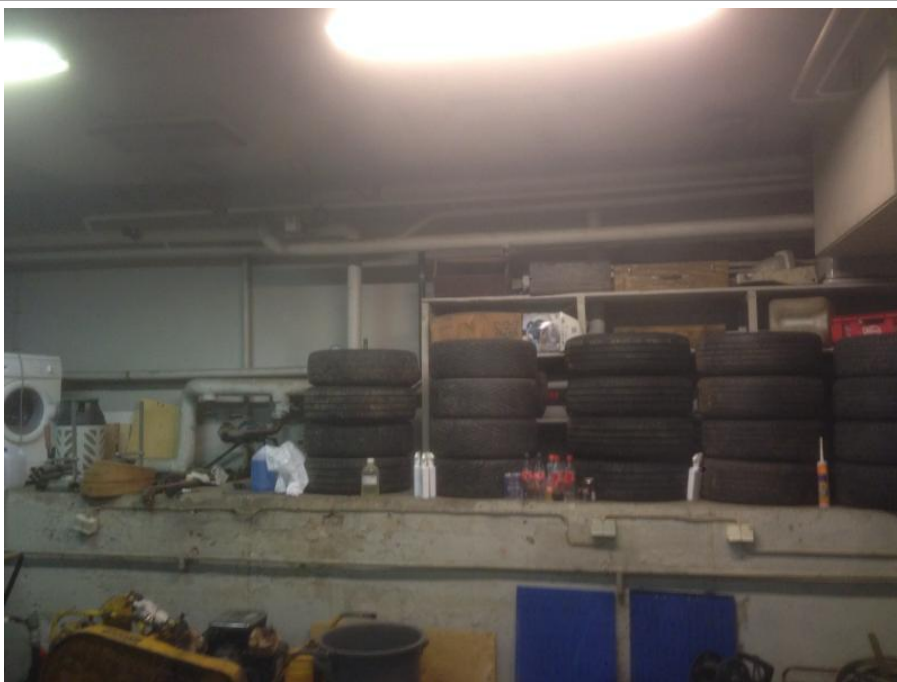
Kuva 64: Korjaamotilan katossa kulkee asbestiputki
