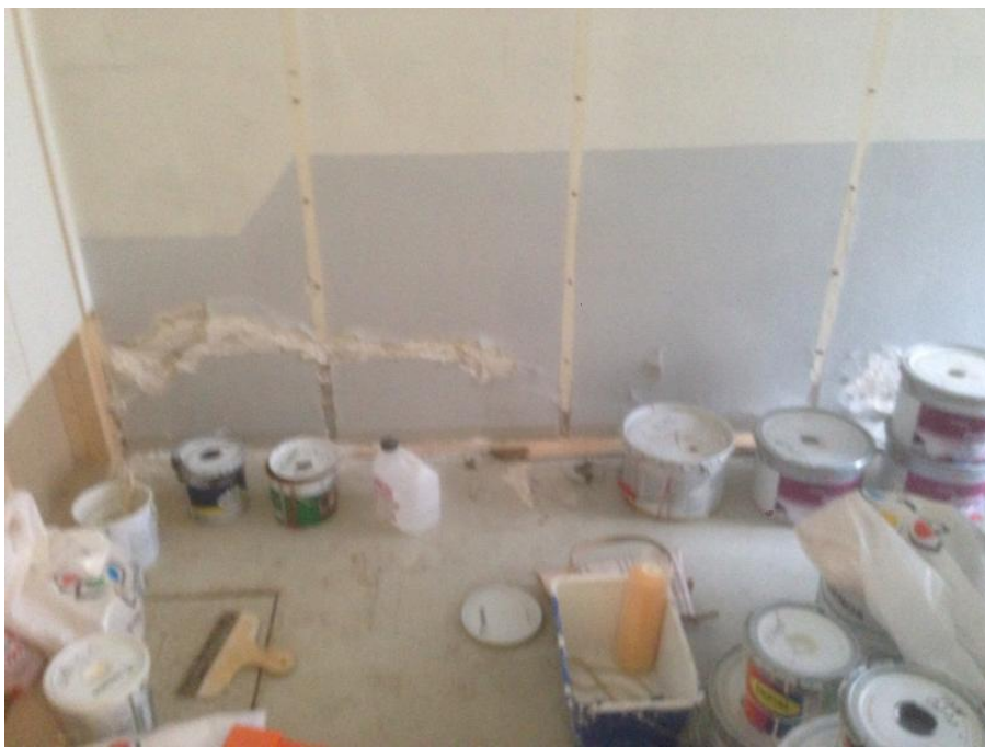
Kuva 35: Kivirakenteisen seinän alaosassa kosteutta
