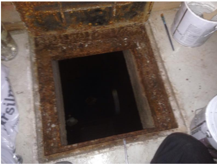
Kuva 37: Varaston lattiassa kaivonkansi, joka johtaa putkikanaaliin
