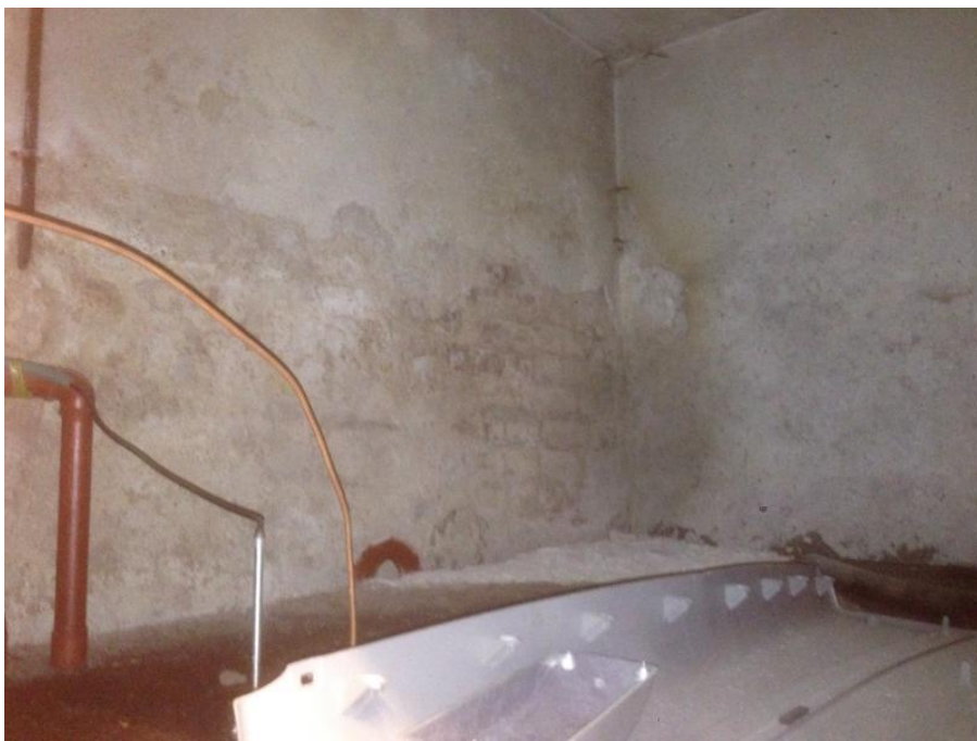
Kuva 70: Kosteusvaurio öljysäiliötilan ulkoseinässä
