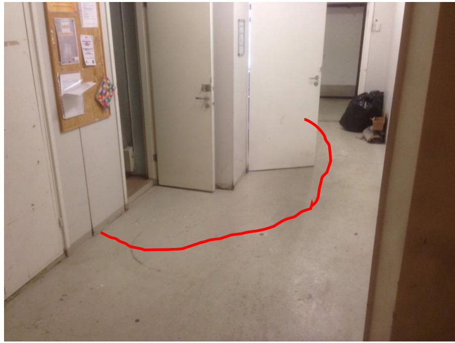
Kuva 30: Käytävän pintalattia kostea
