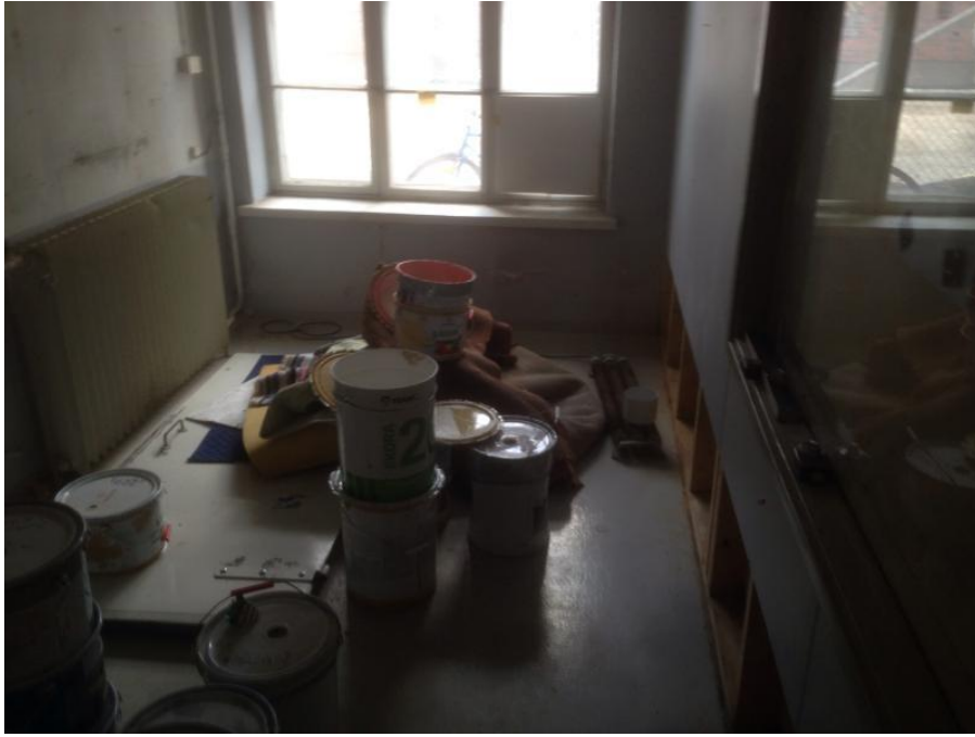
Kuva 36: Varastotilaa. Tilasta otettiin asbesti- ja PAH-jälki
