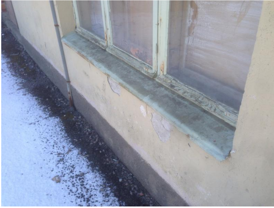
Kuva 104: Vaurioita ikkunapellityksessä ja ikkunoiden karmirakenteissa
