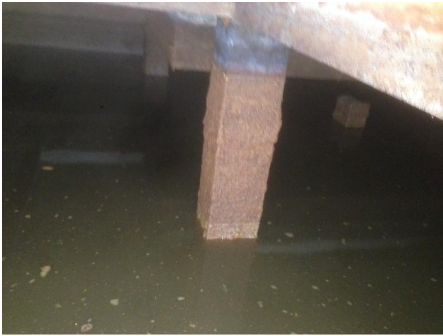
Kuva 15: Vesisäiliöissä oli tarkatushetkellä runsaasti vettä
