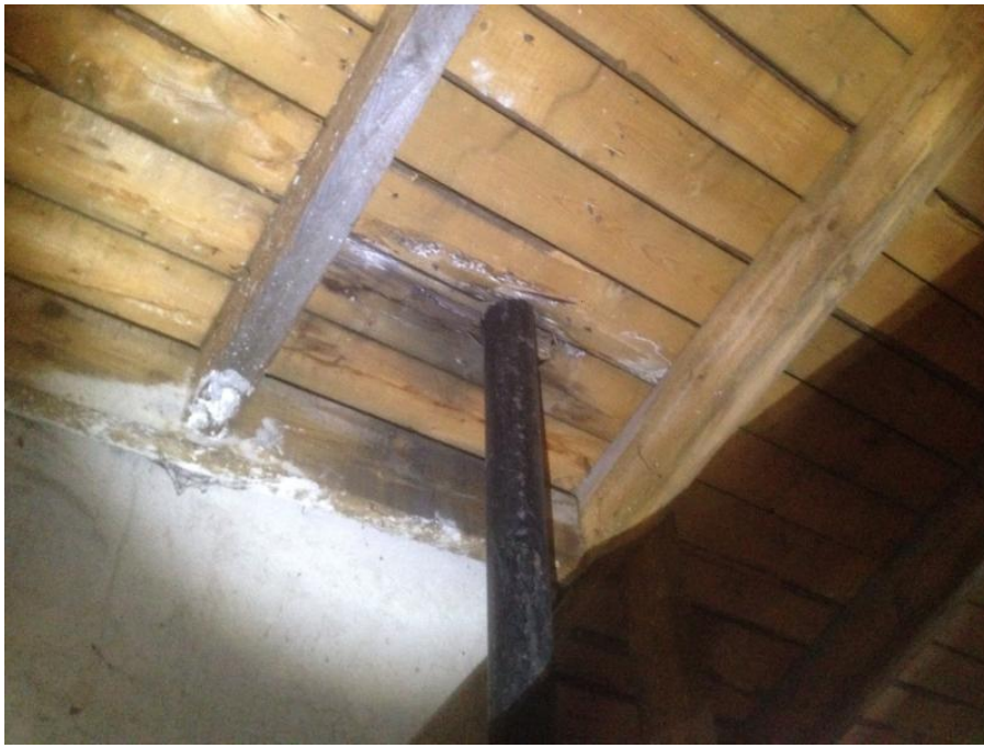
Kuva 58: Viemäriputken ympärillä kosteusvaurioita yläpohjan puurakenteissa
