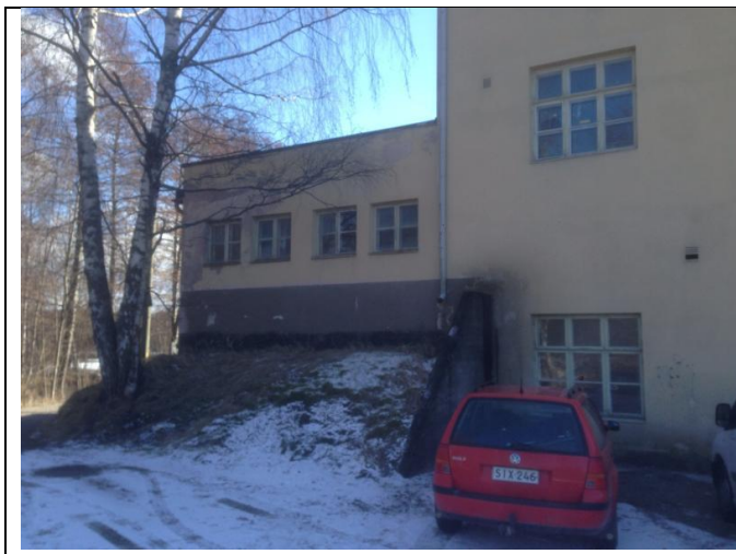
Kuva 1: Rakennuksen ulkoseinää päin on paikoin maata. Seinän sisäpuolella on vanhat vesisäiliöt, jonka vuoksi todennäköisesti maatäytöllä on tuettu perusmuuria.
