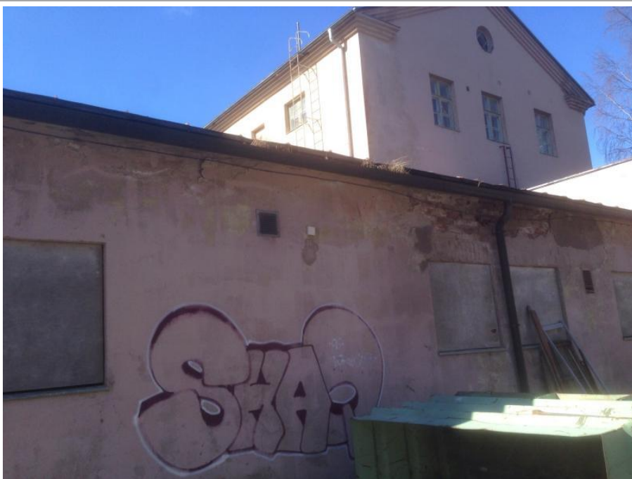
Kuva 72: Ulkoseinässä sadevesirännin ympärillä kosteusvaurioita
