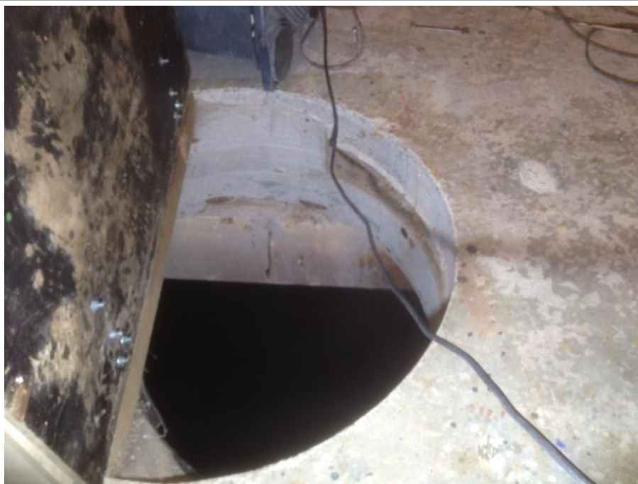
Kuva 14: Alakerran alapuolella on paikoin vesisäiliöt.
