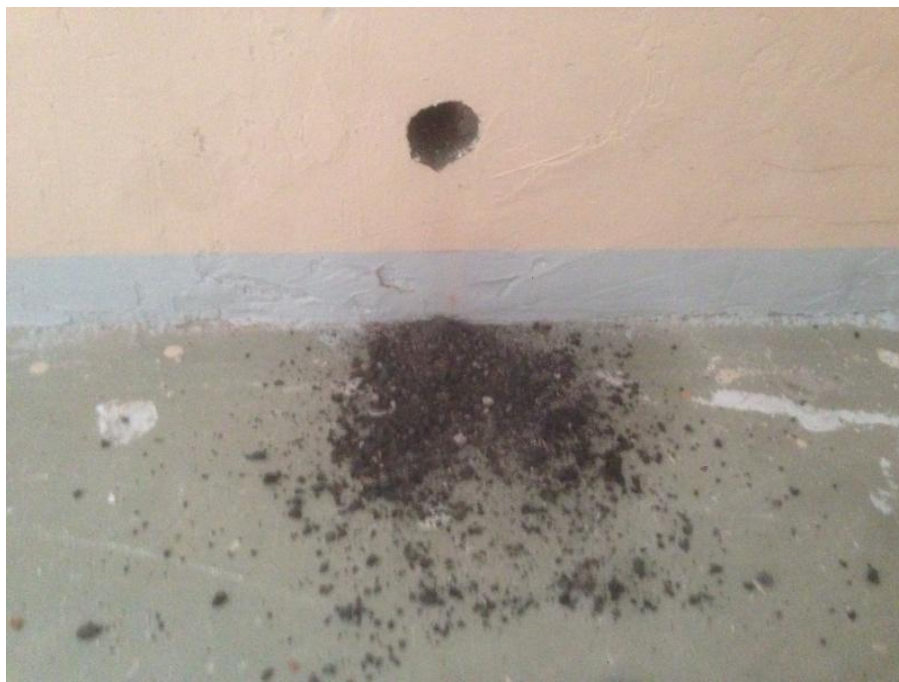
Kuva 13: Ulkoseinän lämmöneristeenä on koksikuonaa. Kuva otettu kosteusmittausta varten poratusta reiästä sekä lämmöneristeestä.
