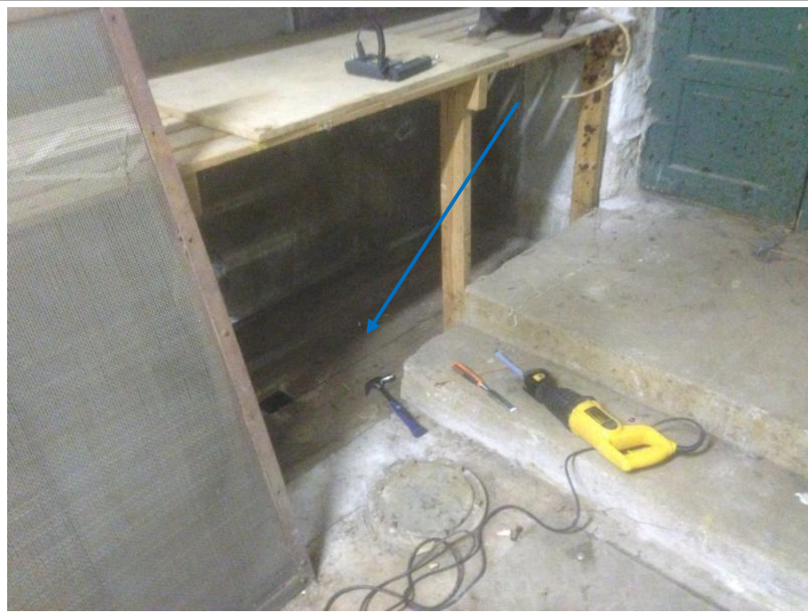
Kuva 24: Vanhassa johtokuiluissa on puurakenteet kosteusvaurioituneet
