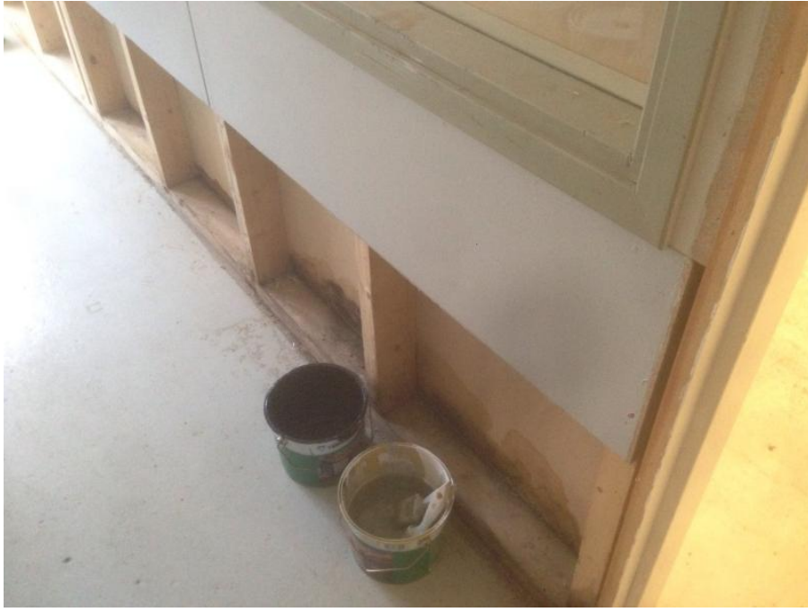
Kuva 34: Lastulevyseinien alaosassa vaurioita
