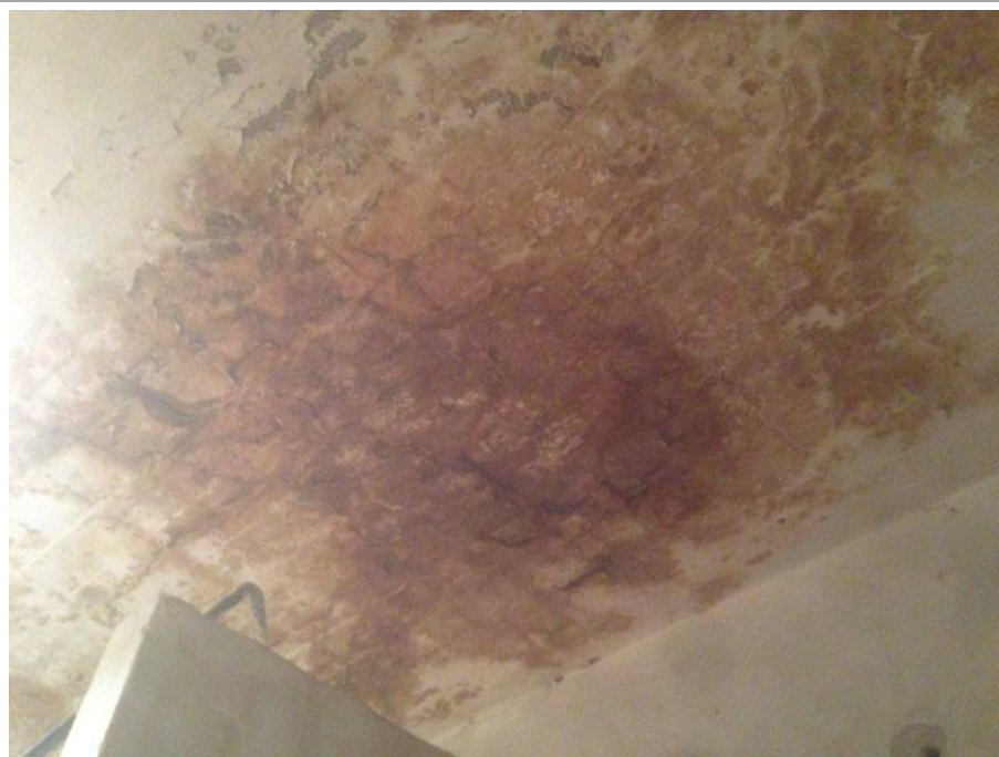
Kuva 22: Kosteusvaurio muuntamo-tilan katossa
