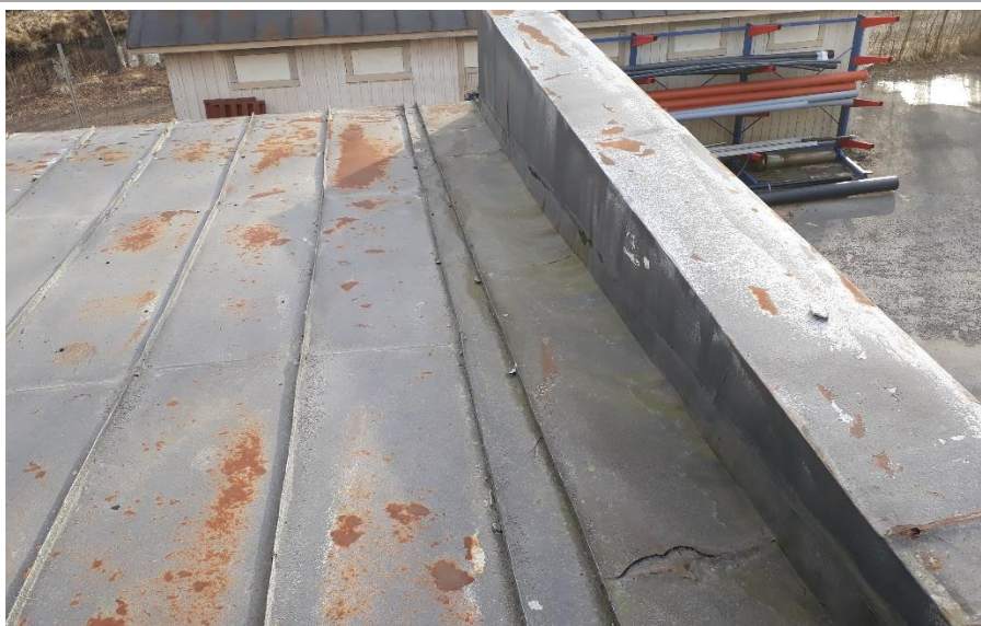
Alimman osan kattoa työsalin 116 kohdalla.
