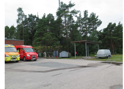
Polttoaineen jakelukatoksesta on jäljellä enää perustukset, pystytolpat ja katos.
