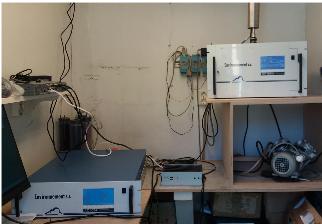
Kuva 2 Hallikadun mittausaseman laitteistoa. Oikealla PM 10 -mittauslaite, vasemmalla NO x -mittauslaite.
