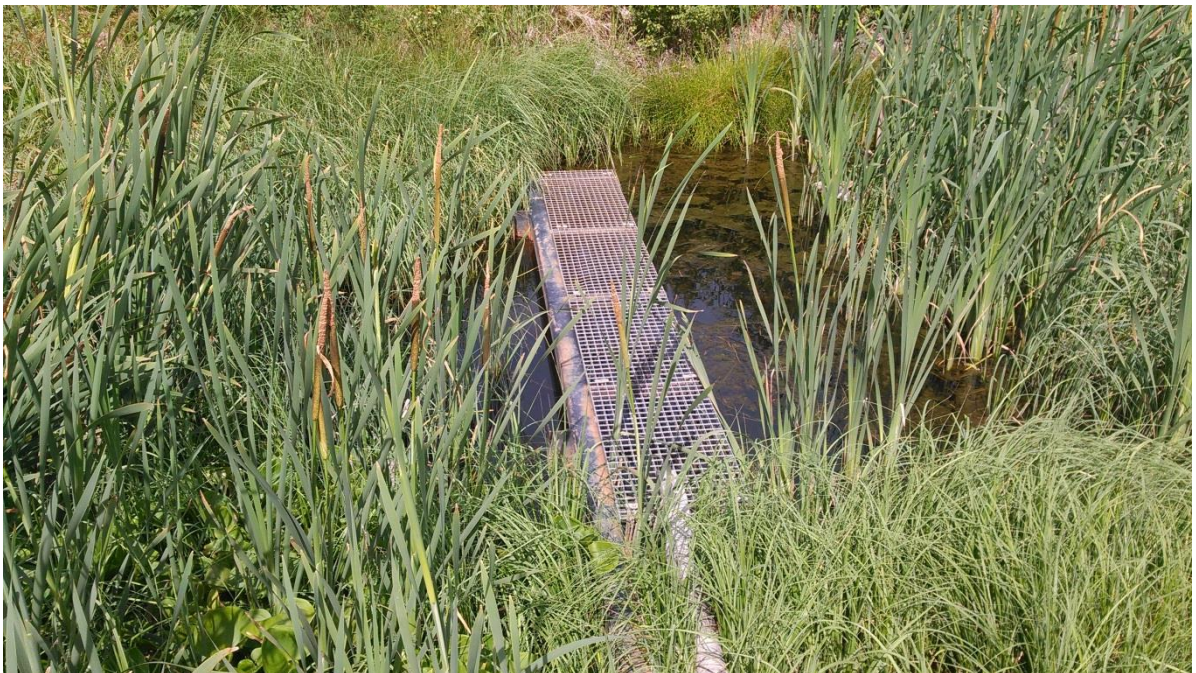
kuva 2.6: Settipato sijaitsee vedenkorkeuksiin nähden liian alhaalla – jos pato suljetaan, vesi lähtee välittömästi virtaamaan padon ylitse.
