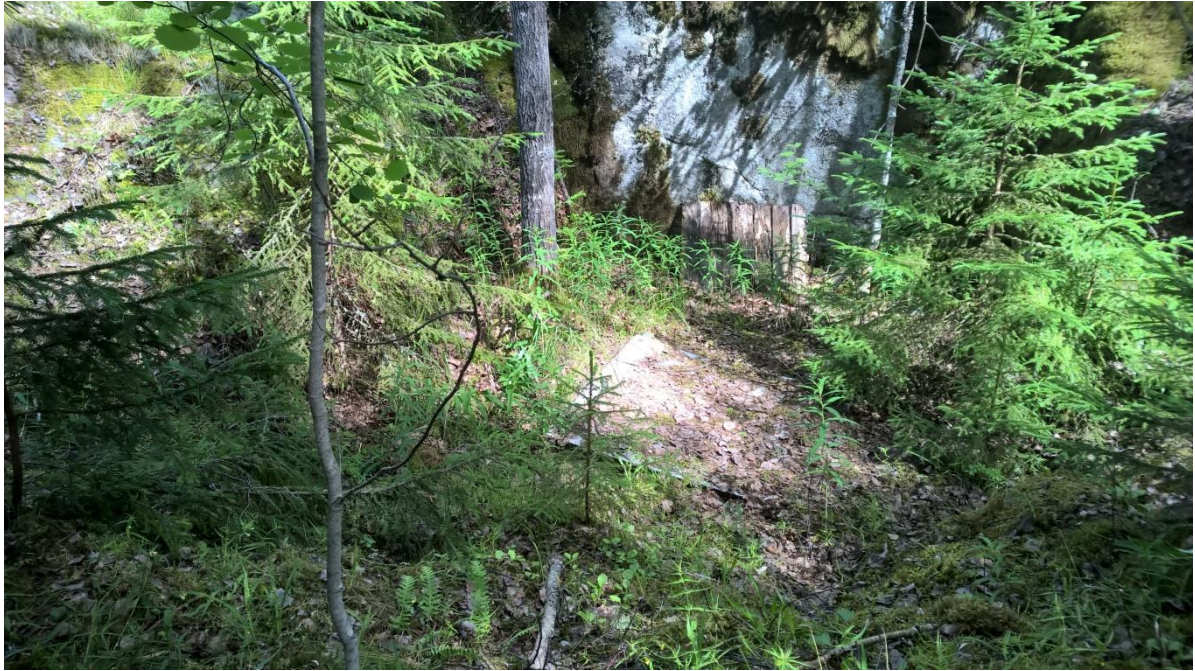
Kuva 2.7: Raakavesitunnelin tarkistuskuilun lahonnut puukansi on korvattu teräslevyllä.
