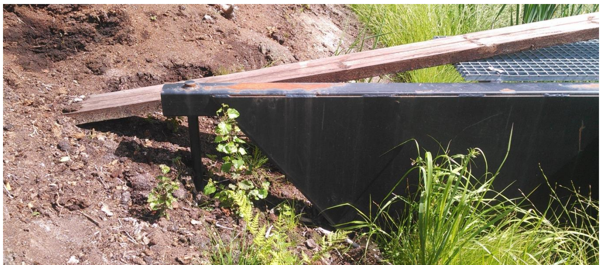
Kuva 2.4: Lakari I varoaltaan settipadon ympärillä maanpinta on painunut ja vesi pääsee virtaamaan padon ympäri.
