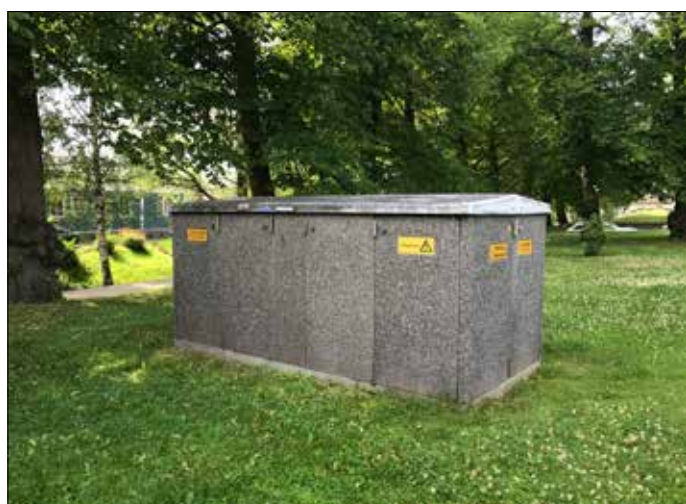
Puistossa oleva kookas sähkökaappi sijaitsee näkyvällä paikalla ja erottuu kauas. Samalla se rikkoo vanhaa puistonäkymää.
