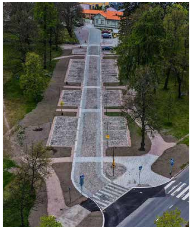
Vuonna 2015 aloitetun muutostyön tulos Itäkadun varrella. Katu oli aikaisemmin sorapintainen. Nykyinen pinta on toteutettu mm. mukulakivistä ja noppakivistä, kuten Vanhan Rauman 2000-luvulla uusitut katupinnatkin. Vasemmalla Katariina Westerlingin puisto ja oikealla Tekkalan puisto. Kuvassa vielä ilman kasvillisuutta oleva muutosalue erottuu erityisen voimakkaana. (Kuva Rauma ennen ja nyt facebook-ryhmä.)
