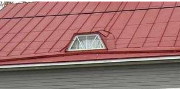
Kulmikas kattolyhtymalli on eräs käyttökelpoinen vaihtoehto perinteisemmistä malleista. Mahdollisten uusien kattolyhtyjien mittasuhteisiin ja rakenteiden sirouteen tulee kiinnittää erityistä huomiota.
