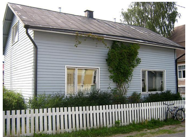
1950-60-luvuilla käytetyt yhtenäiset vaakasuuntaiset ulkokuoraukset edustavat aikakauden tyyppillistä rakentamistapaa ja on syytä säilyttää.
