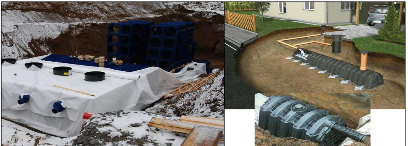
Kuva 24. Maanalaisia viivytyksjärjestelmiä. Vasemmalla suurempi, noin 300 m 3 Wavin Labkon viivytykskennosto rakenteilla kerrostaloalueelle 15 ja oikealla Uponorin mm. pientaloon soveltuva hulevesitunneli 16
